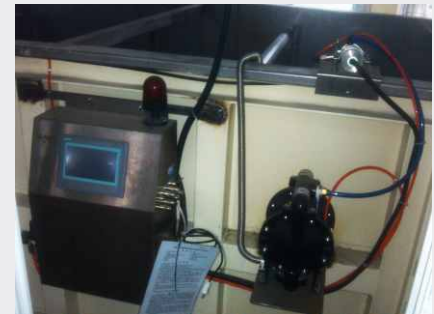
产品应用现场灵活的安装方式
